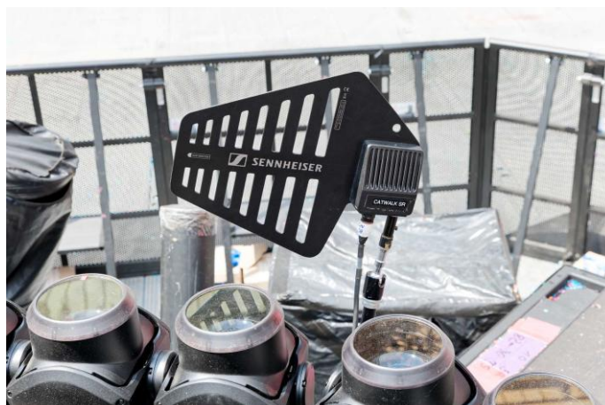
Bis zu 100 m lange CAT-Kabel verbanden die DAD-Antennen mit der jeweiligen Spectera Base Station
